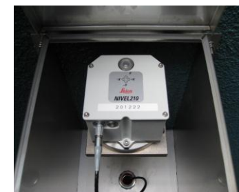
建屋傾斜計設置状況
