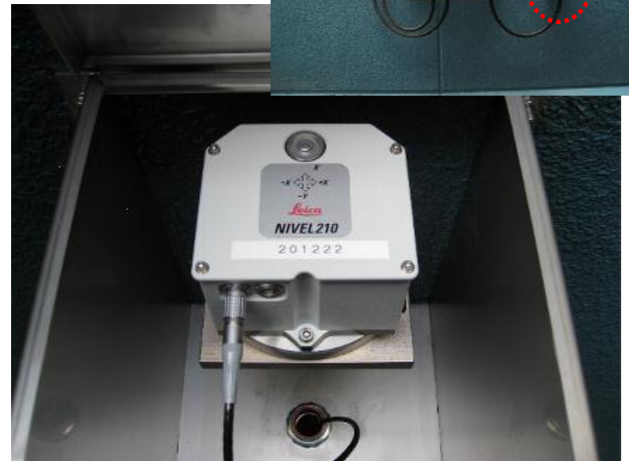
傾斜計(原子炉建屋壁面)
