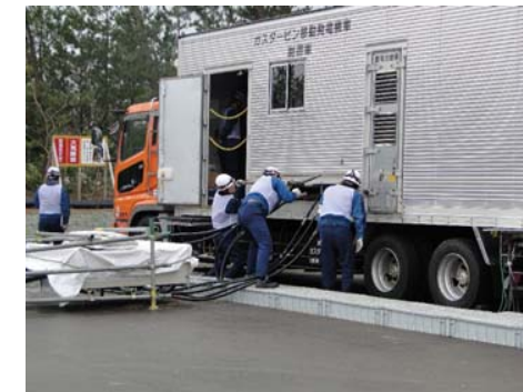
GTGによる電源供給訓練風景
