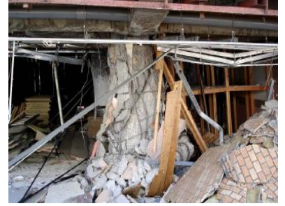
2007年中越沖地震での柱の被害(柏崎市)
