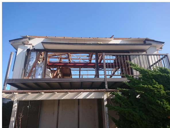
台風による住宅被害の例
