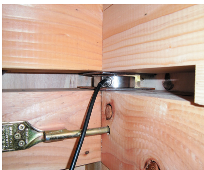
4 観測小屋に設置された荷重計
